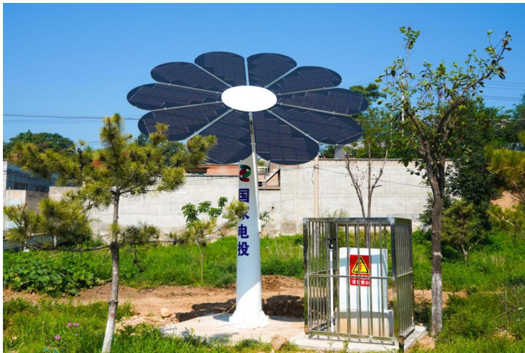
图 3-15 某智慧零碳电厂项目光伏向日葵场景
