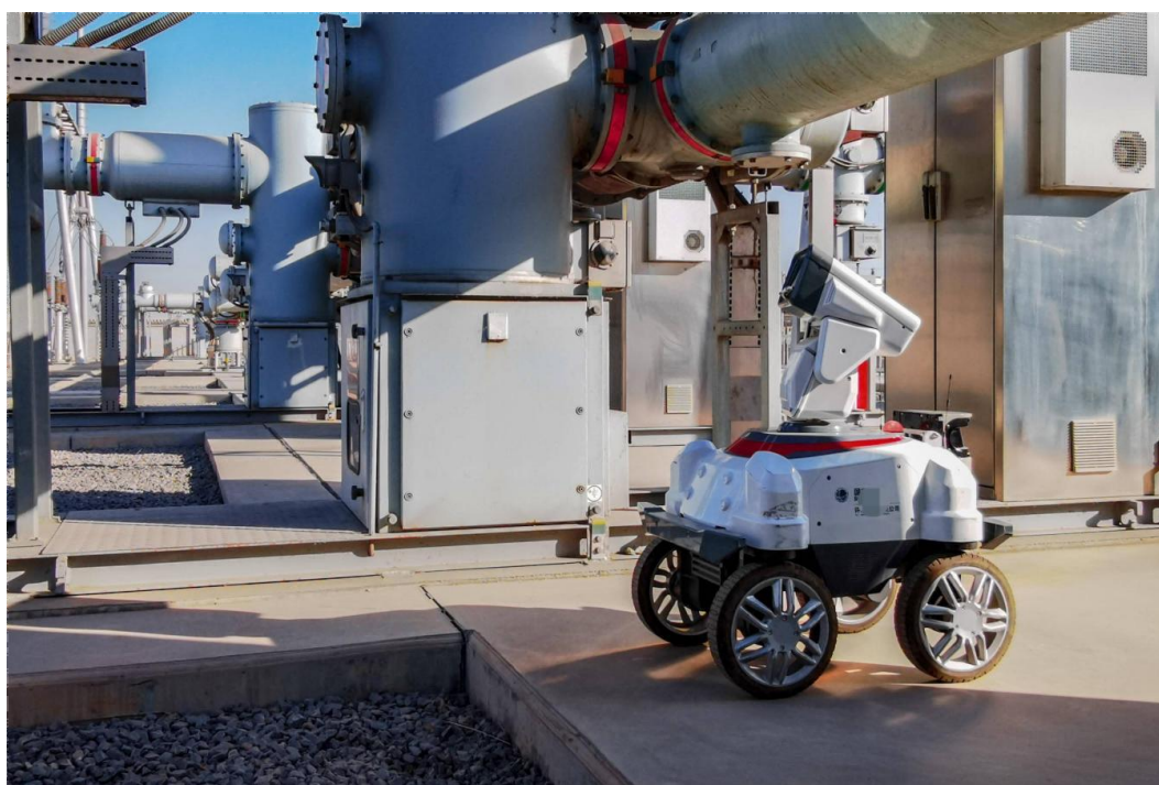
图 3-11 某变电站机器人巡检
