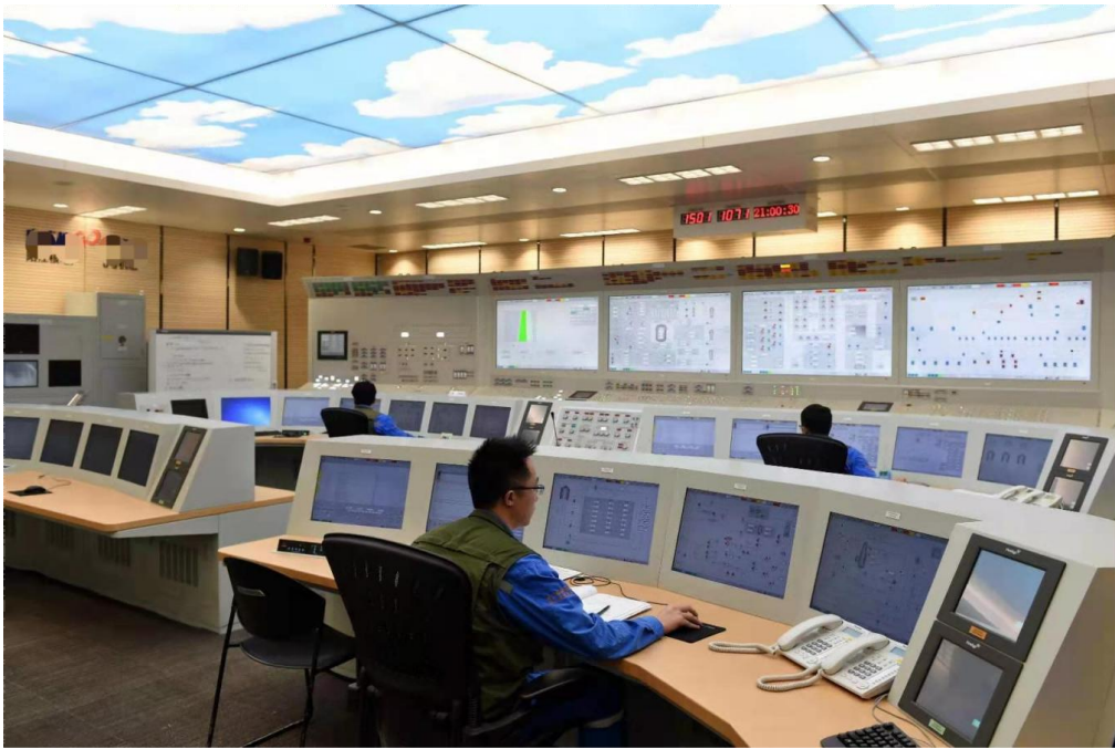
图 3-10 某核电自主可控运行控制系统
